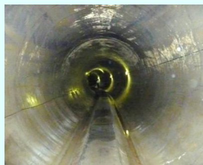
貯留施設：上目黒幹線 貯留量9,400m 3
