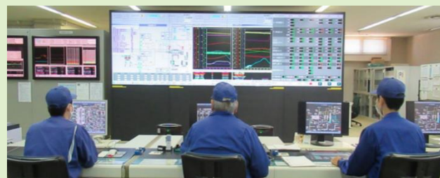
汚泥処理施設の監視室
