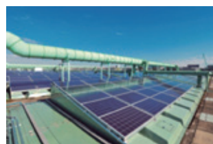
◀太陽光発電設備を導入拡大しています。1000kW(メガワット級)の設備を含めた44か所に導入しています。
