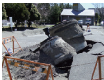
◀マンホールの浮上被害事例(東日本大震災・平成23年、浦安市)
