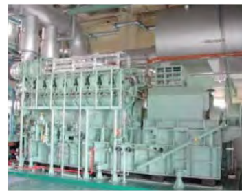
非常用発電機
