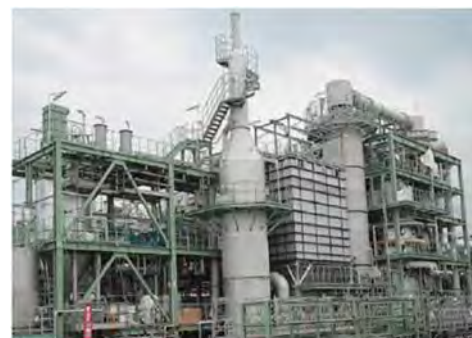
汚泥ガス化設備
