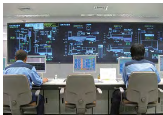
水再生センターの中央監視盤室
