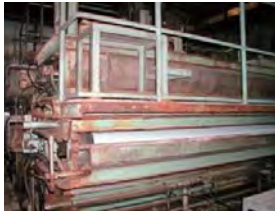
老朽化した汚泥脱水機
