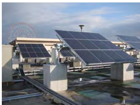
新型太陽光発電設備 「一軸追尾」タイプ
