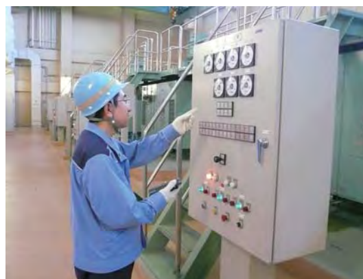
ポンプ設備の点検
