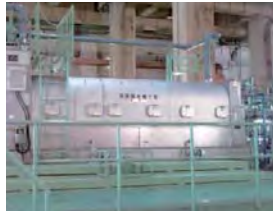
更新後の省エネ型脱水機
