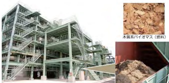
木質系バイオマスと下水汚泥の混合焼却施設
