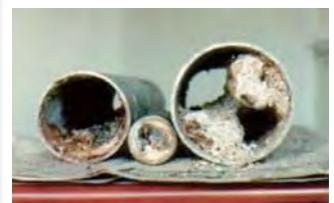
油で詰まった屋内の下水排水管
