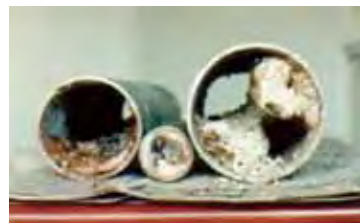
油で詰まった屋内の下水排水管
