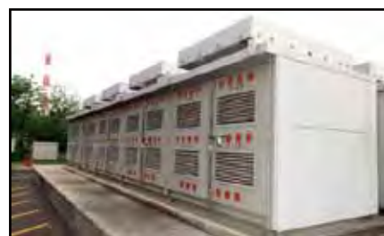
NaS電池（砂町水再生センター）
