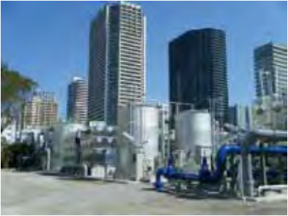
芝浦水再生センター造水施設
