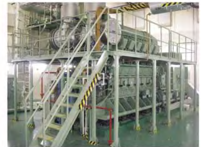
非常用発電機（清瀬水再生センター）
