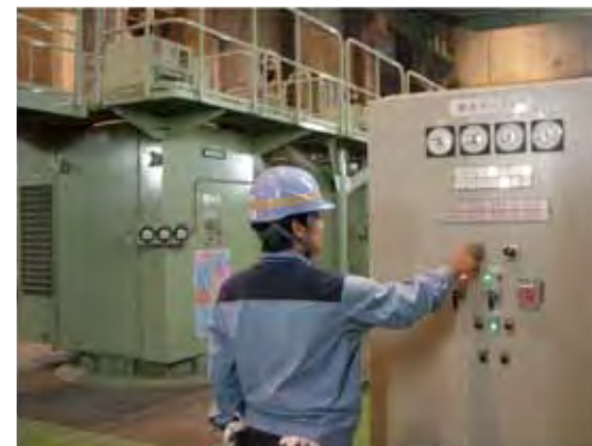
ポンプ設備の点検
