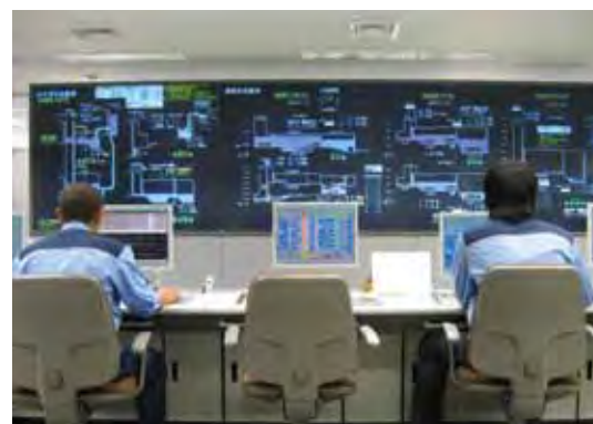
水再生センターの中央監視盤室
