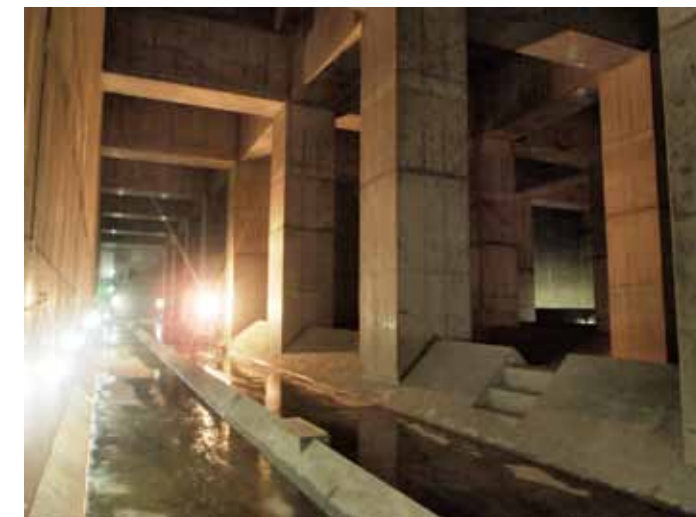
野川雨水貯留池(平成26年度稼働)
