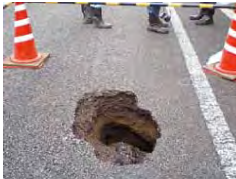
道路陥没状況
