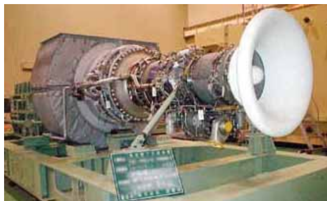
ガスタービン発電機(13,000kVA)
