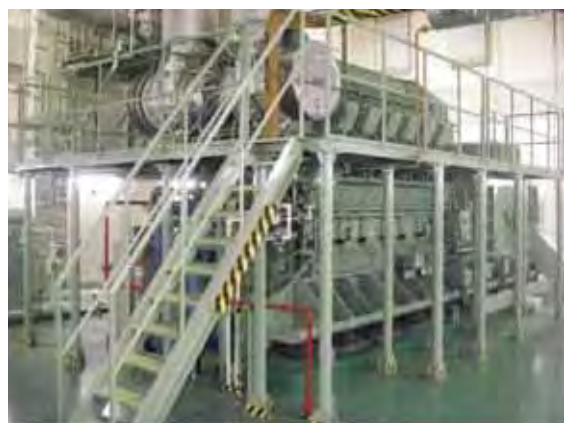
非常用発電機(清瀬水再生センター)
