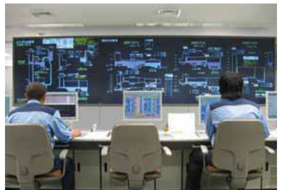
水再生センターの中央監視盤室
