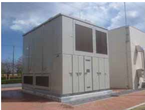
NaS電池(浅川水再生センター)
