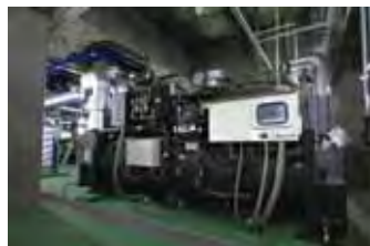
熱供給システムのヒートポンプ
