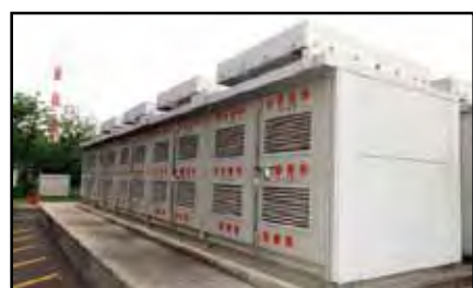
NaS電池（砂町水再生センター）
