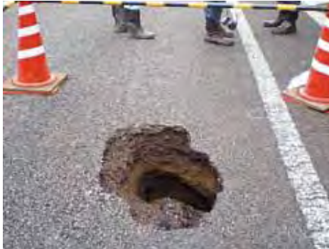
道路陥没状況
