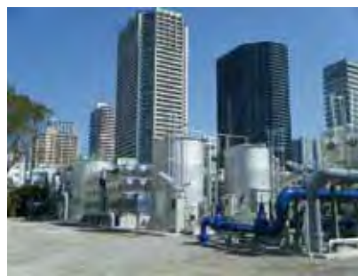
芝浦水再生センター造水施設
