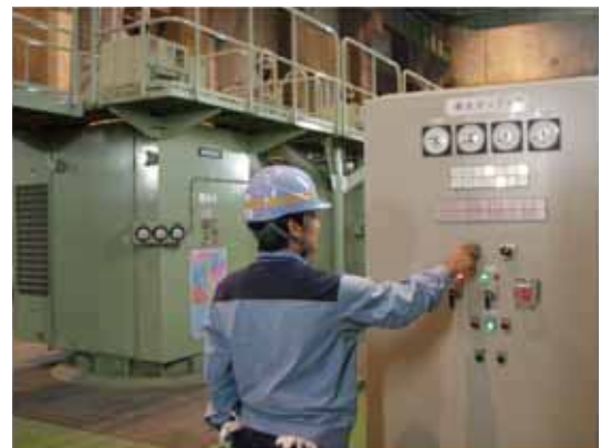
ポンプ設備の点検
