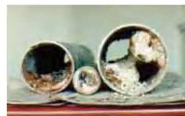
油で詰まった屋内の下水排水管
