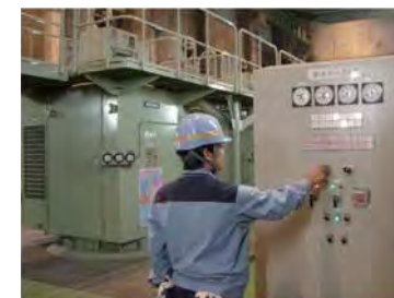
ポンプ設備の点検
