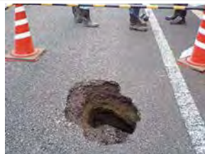
道路陥没状況
