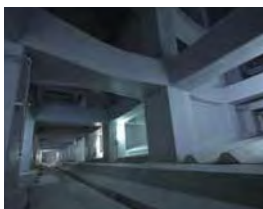
貯留施設 (芝浦水再生センター)
