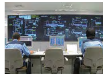
水再生センターの中央監視盤室
