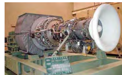
ガスタービン発電機(13,000kVA)
