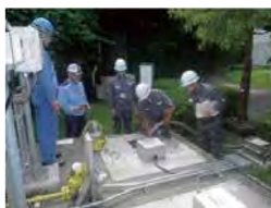
災害時のし尿の搬入・受入れ訓練 (北多摩二号水再生センター)
