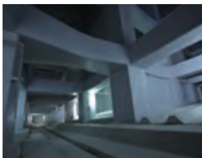
貯留施設 (芝浦水再生センター)
