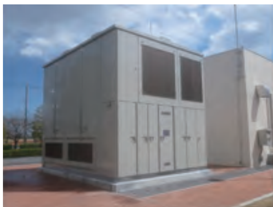
NaS電池 (浅川水再生センター)
