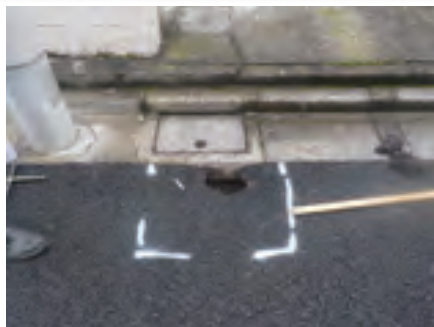
道路陥没状況
