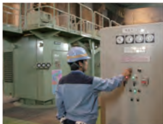
ポンプ設備の点検
