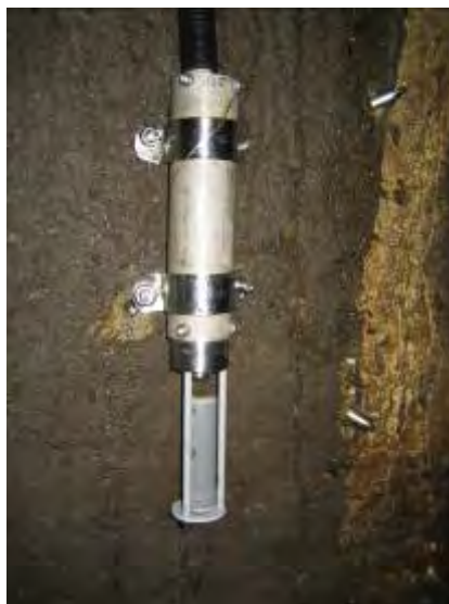
図 5 簡易型水位検出器の設置状況例
