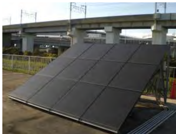
図 5 固定架台＋薄膜型太陽電池
