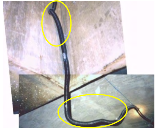
図5 伝送不能箇所付近のケーブル状況 (事故発生後)
