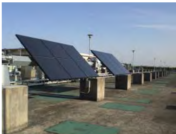
図 4 一軸追尾架台＋薄膜型太陽電池
