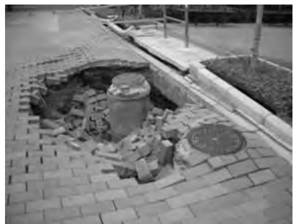
図-9 宅内用雨水柵周囲の陥没状況
