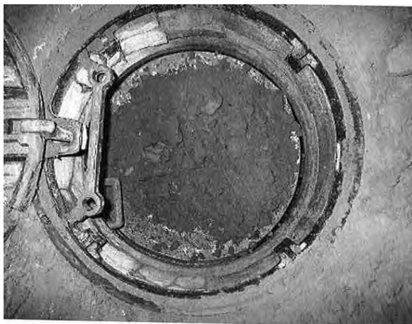
図-6 人孔の土砂の堆積状況
