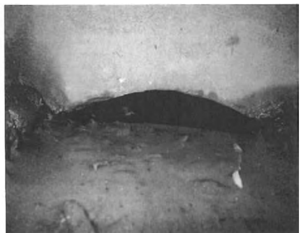
図-7 雨水管の土砂の堆積状況
