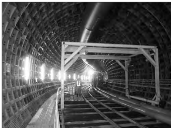
第二溜池幹線 (大口径機)
