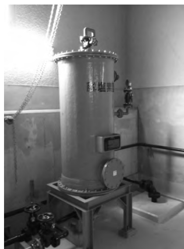
脱塩素装置（浅川水再生センター）
