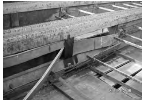
汚泥かき寄せ機破損状
