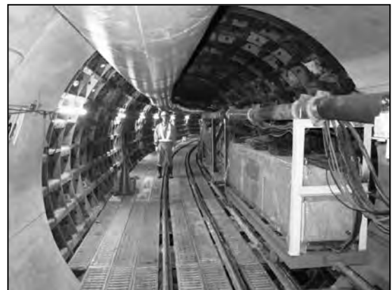
勝どき幹線 (中口径機)
