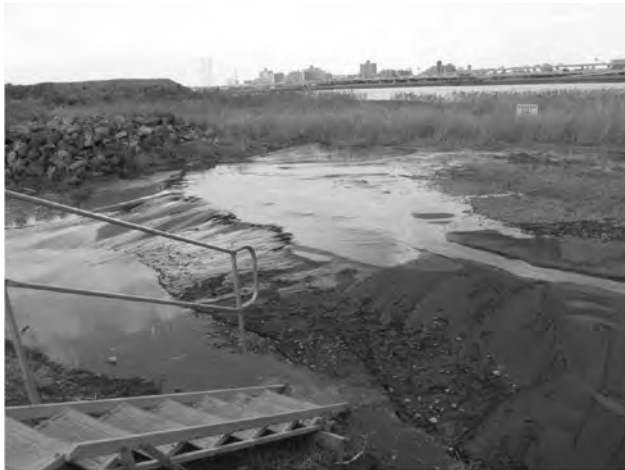
図6. 液状化発生状況
