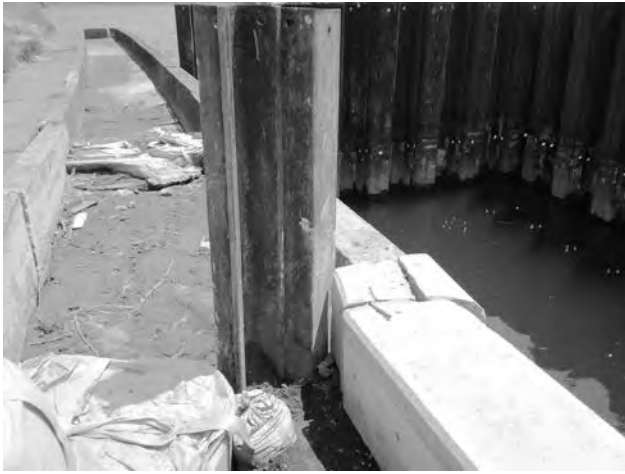
図4. 吐口翼部・護岸鋼矢板接合部損傷状況
