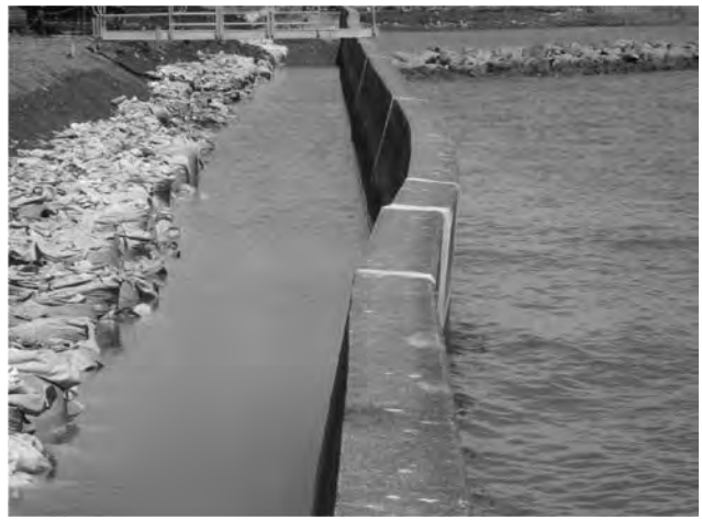
図5. 護岸変位状況
