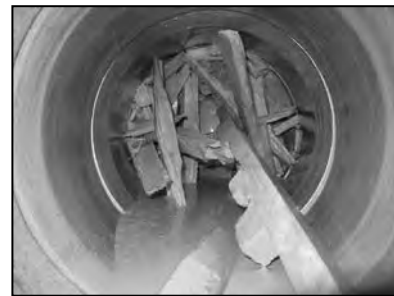
図-10 配管内閉塞状況
