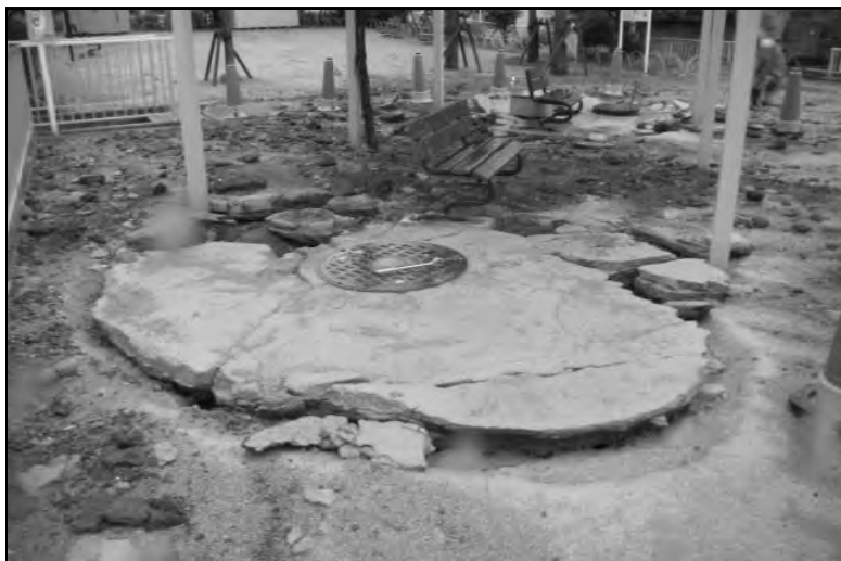
写真 1 事故後の人孔上部の状況
