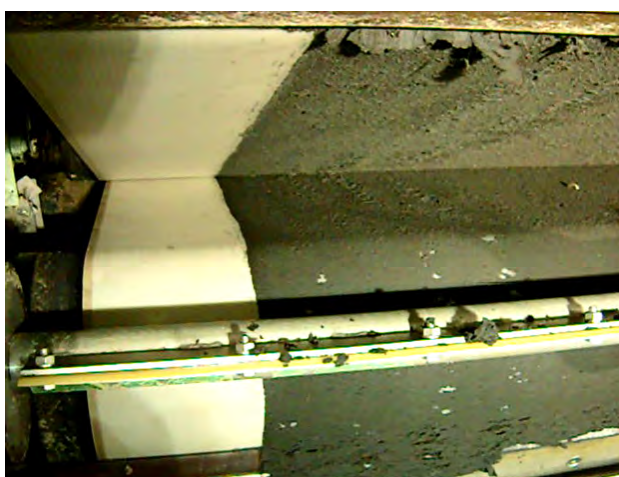
写真 2.2 余剰汚泥の脱水状況 (2週間)
