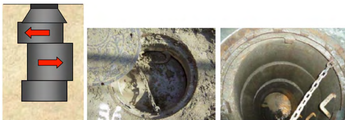
図 2 目地ずれ被害状況（浦安市） 中央：土砂堆積状況 右：躯体ずれ状況
