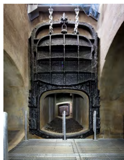
写真 27 工事完了後の阻水扉 (平成 25 年撮影)
