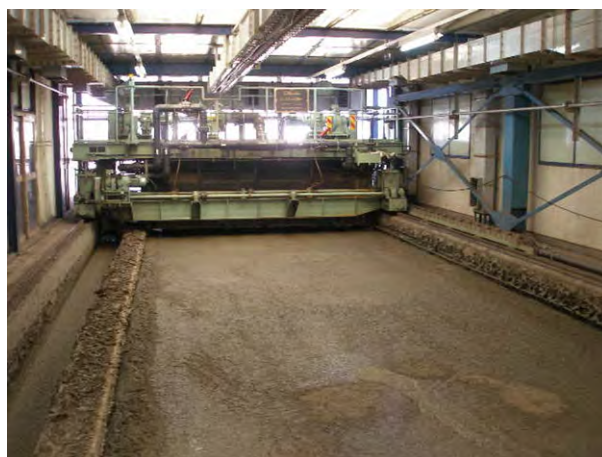
写真 1.2 加圧浮上濃縮設備
