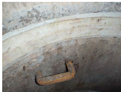
目地部 足掛直上（6 ヶ月後）
