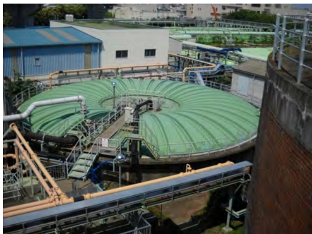
写真 1.1 重力濃縮設備
