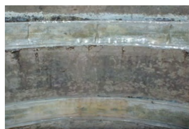
目地部 詳細（6 ヶ月後）
