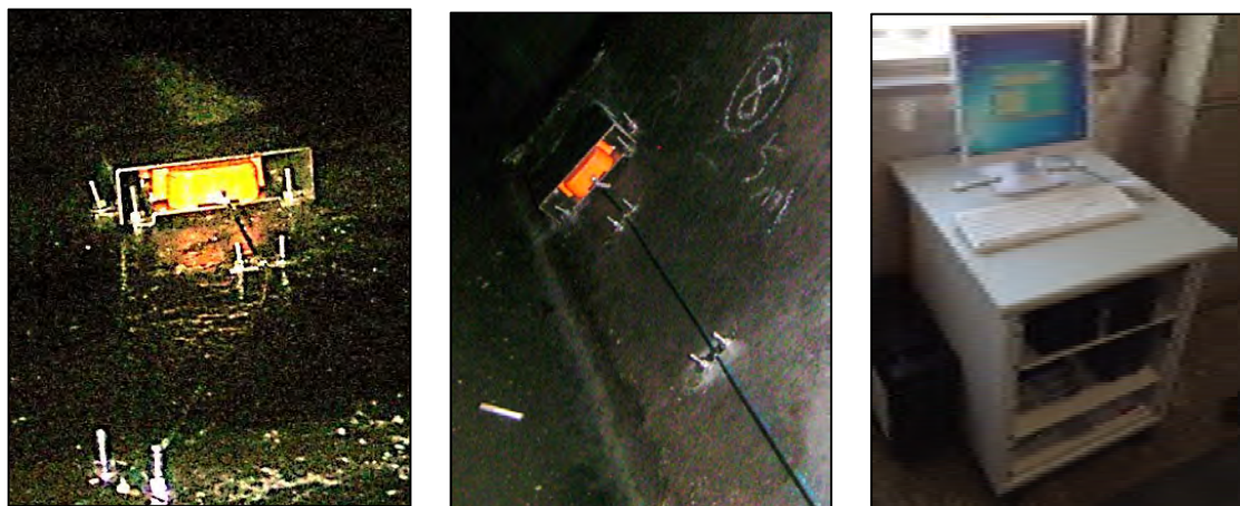
水位計設置状況①
