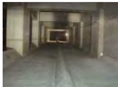
＜貯留施設（砂町水再生センター）＞
