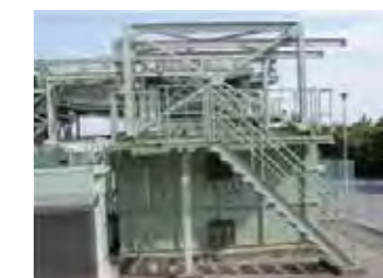
水再生センターの脱臭設備
