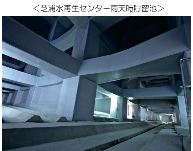
◀ 芝浦水再生センター雨天時貯留池は、高浜運河などの水質改善を目的とした施設です。
