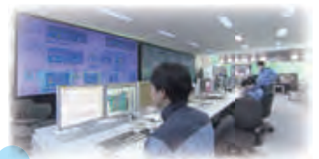
下水道施設の運転管理
