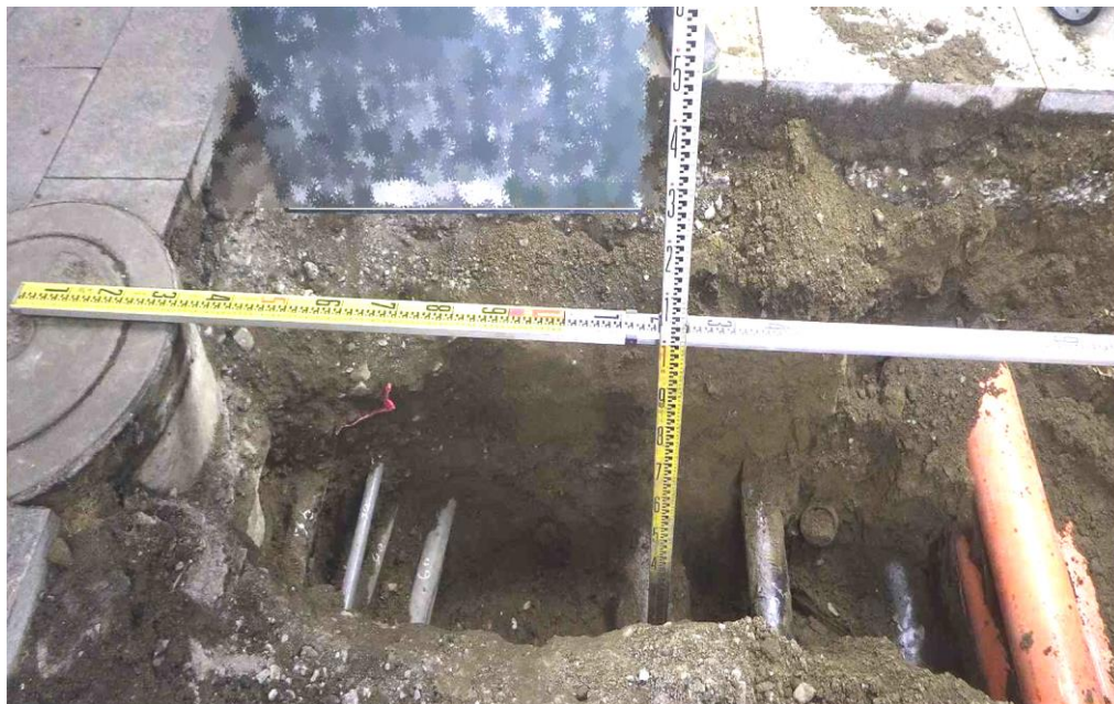
輻輳する埋設物
