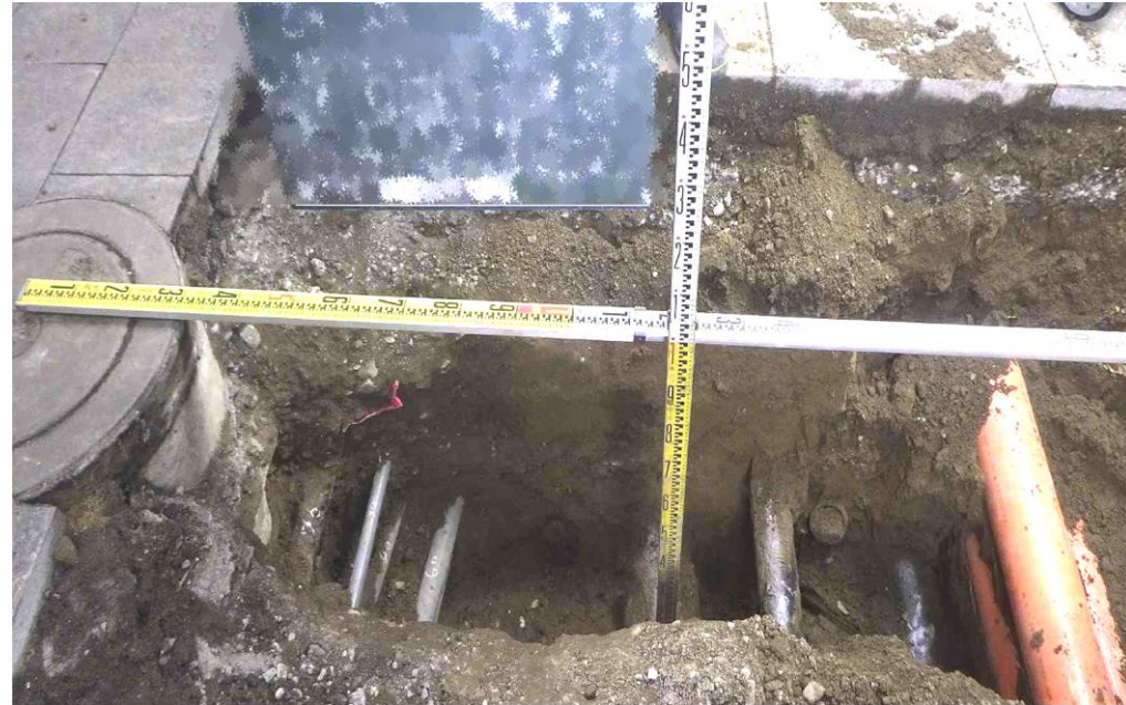
輻輳する埋設物
