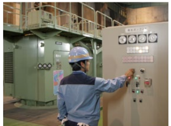
ポンプ設備の点検
