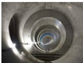
多摩川上流雨水幹線 (平成16年度 全線供用開始)
