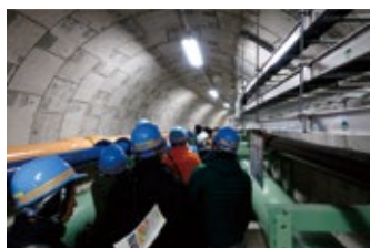
北多摩二号・浅川 水再生センター間連絡管
