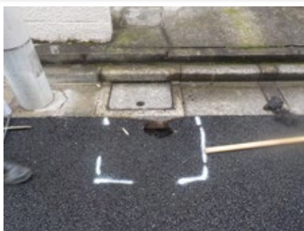
道路陥没状況
