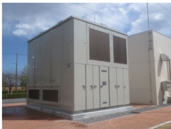
NaS電池 (浅川水再生センター)
