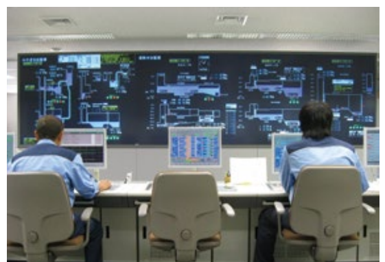
水再生センターの中央監視盤室
