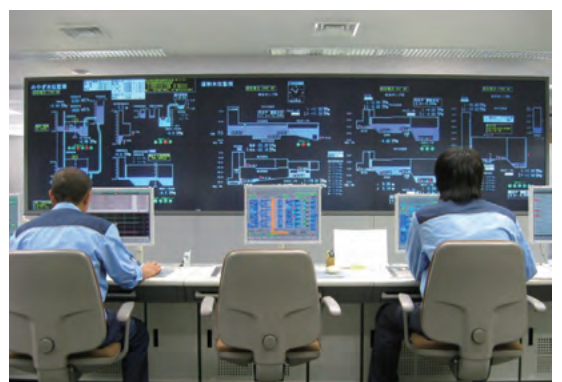
水再生センターの中央監視盤室
