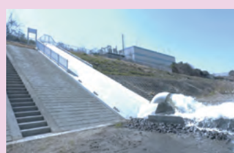
小水力発電設備 (南多摩水再生センター)
