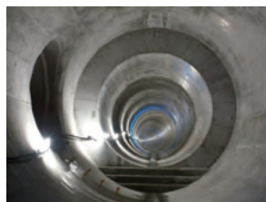
多摩川上流雨水幹線 (平成16年度 全線供用開始)
