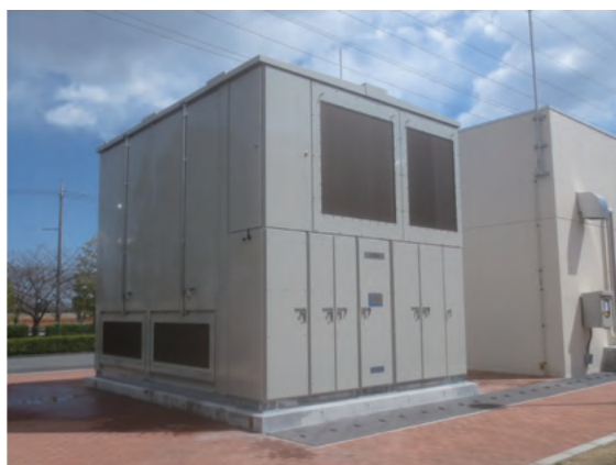
NaS電池 (浅川水再生センター)
