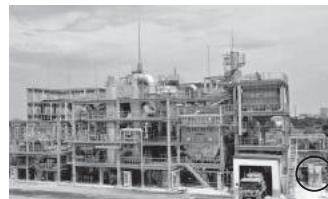
汚泥ガス化炉
