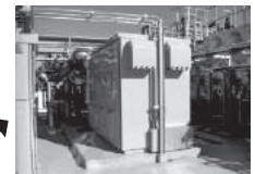
バイナリー発電設備
