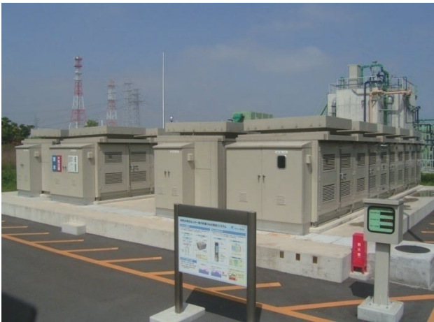
NaS電池 (砂町水再生センター)
