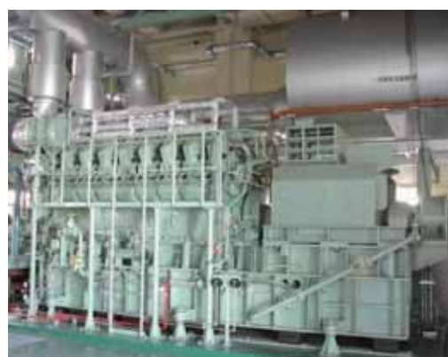
▲停電に備えた非常用発電機
