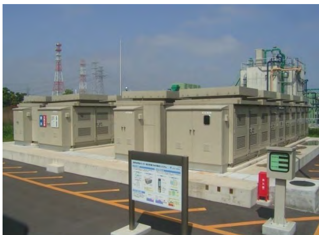
NaS電池（砂町水再生センター）
