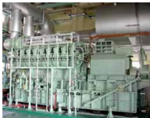
▲停電に備えた非常用発電機
