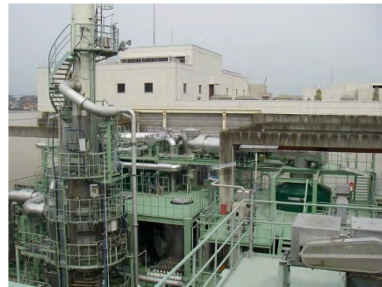
ターボ型流動焼却炉（浅川水再生センター）
