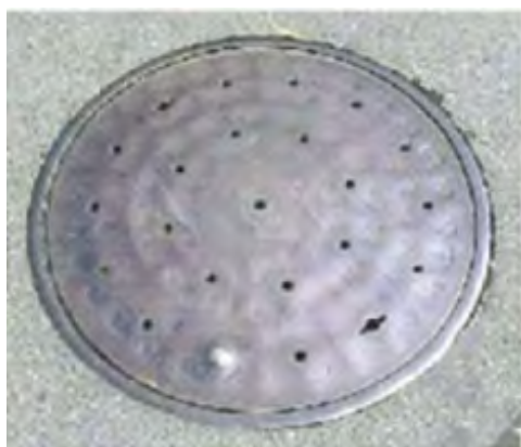
老朽化ですり減ったマンホール蓋
