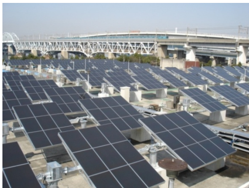
図表5-4 葛西水再生センター 太陽光発電設備（一軸追尾タイプ）
