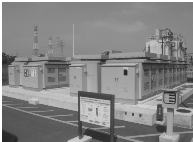
図表3-17 NaS電池（砂町水再生センター）
