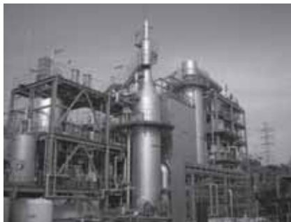
図表 4-14 汚泥ガス化炉施設（清瀬水再生センター）
