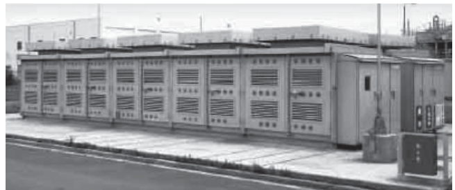
図表4-16 NaS電池（多摩川上流水再生センター）
