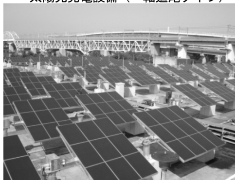
図表5-10 葛西水再生センター 太陽光発電設備（一軸追尾タイプ）
