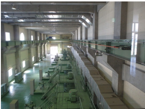
西日暮里系ポンプ室の雨水ポンプ設備
