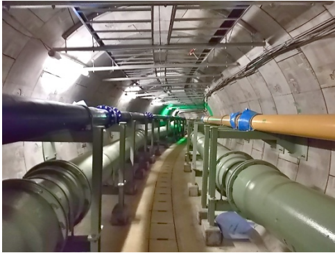
汚水管（薄緑色）や汚泥管（オレンジ色）が配置された連絡管内部
