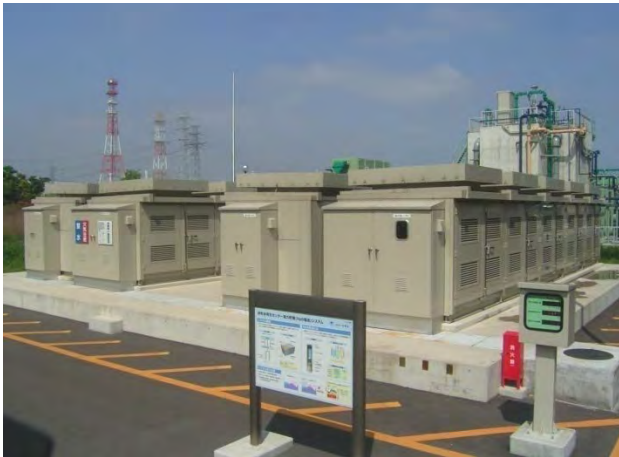
図表3-17 NaS電池（砂町水再生センター）
