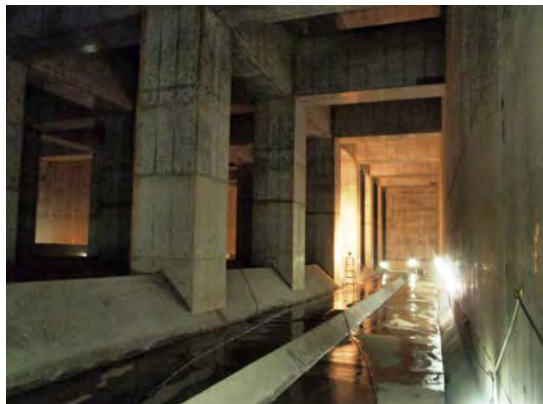
図表 4-21 野川下流部雨水貯留池
