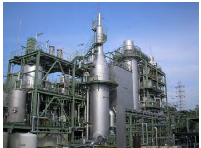
図表4-12 汚泥ガス化炉施設（清瀬水再生センター）
