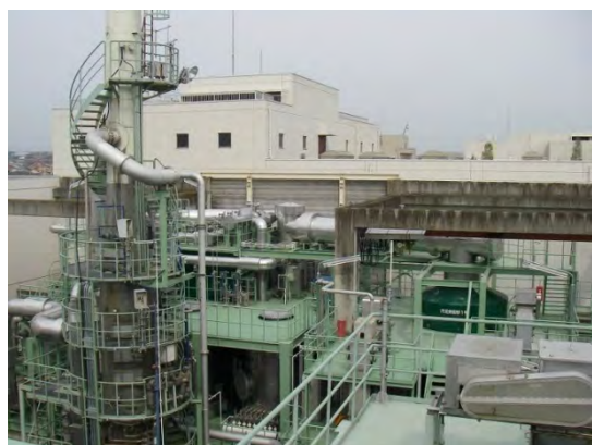
図表 4-13 ターボ型流動焼却炉（浅川水再生センター）
