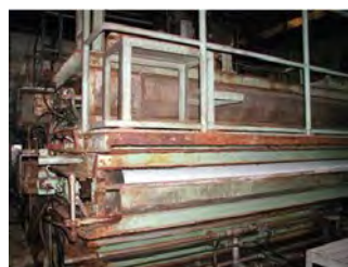
図表 4-14 更新にあわせて省エネ型の脱水機を導入
