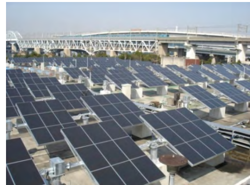
図表5-10 葛西水再生センター 太陽光発電設備(一軸追尾タイプ)
