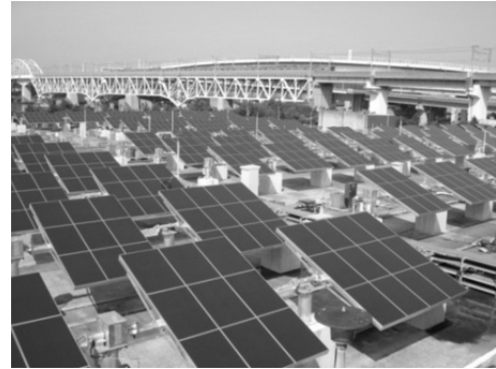
図表5-10 葛西水再生センター 太陽光発電設備（一軸追尾タイプ）
