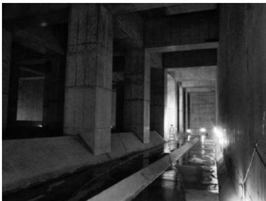
図表4-17 野川下流部雨水貯留池
