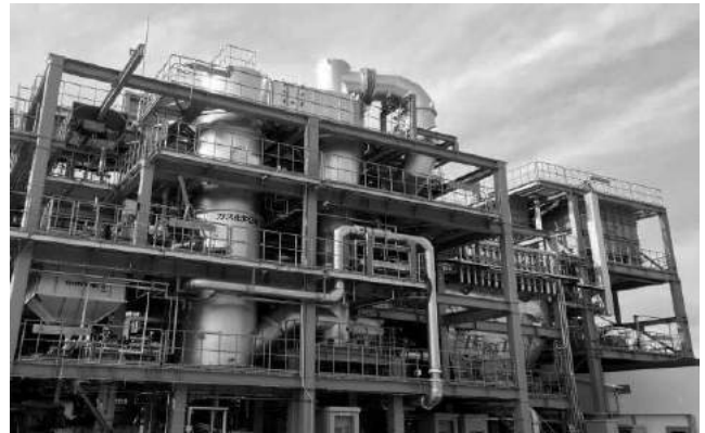
図表4-20 汚泥ガス化炉(南多摩水再生センター)
