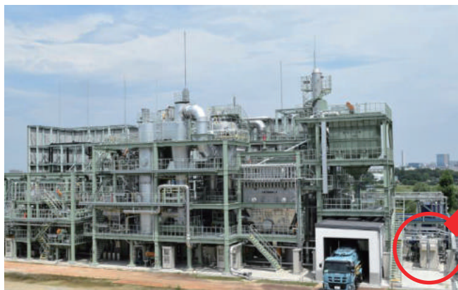
南多摩水再生センター汚泥ガス化炉
