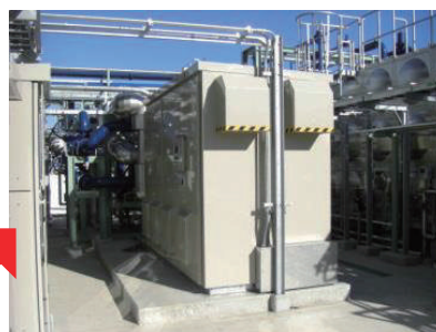
バイナリー発電設備
