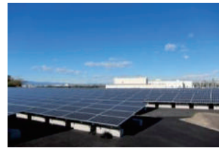
メガワット級太陽光発電設備 (森ヶ崎水再生センター、南多摩水再生センター)
