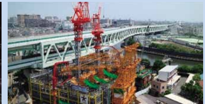
王子第二ポンプ所
