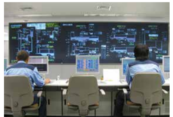
水再生センターの中央監視盤室
