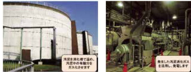
汚泥消化ガス発電（消化槽・発電機）
