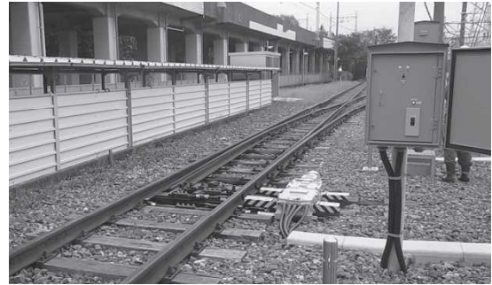
【模擬実習設備】
